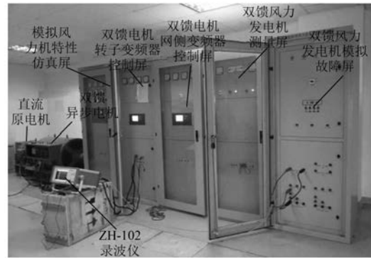
图 3 双馈风力发电机组故障容错系统试验装置
