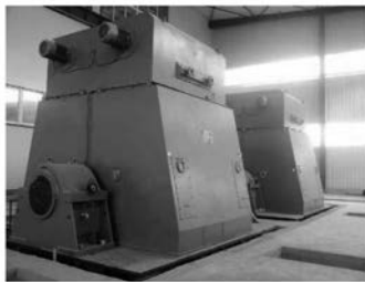
图 15 型式试验机组实物布置
