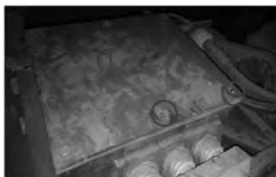
图2 牵引电机接线盒盖板紧固螺栓断裂
