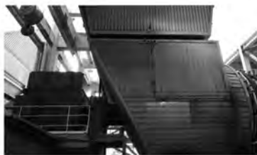
图1 某台1 000 MW机组配套引风机
