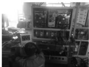
图7 变压器空载测量实物图
