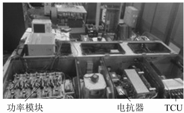
图9 电机控制试验台
